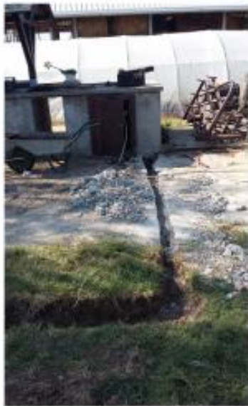
Део кабловске трасе почев од просторије пумпног агрегата
