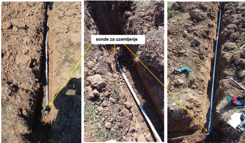
Слика 12- Изглед и начин извођења линијског уземљивача у оквиру система заштитног уземљења хибридног постројења
